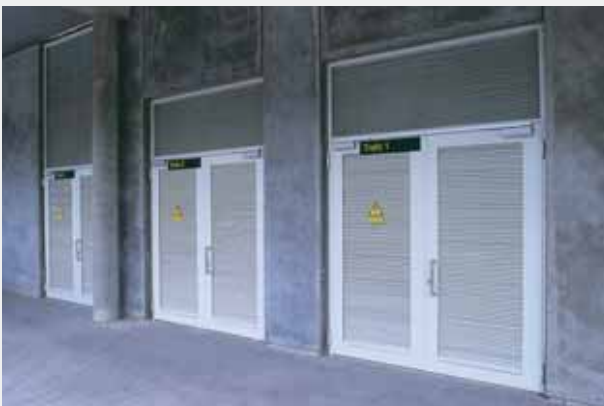
"Teckentrup" transformer doors, dw 54-2
