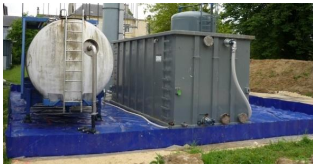
bac pour matériel dépollution sur chantier
