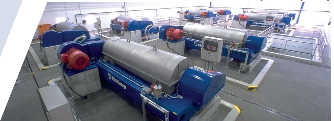
Installation von Flottweg OSE Eindickzentrifugen in Hamburg.
